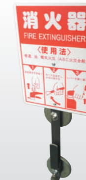
■ 消火器キャッチャー
